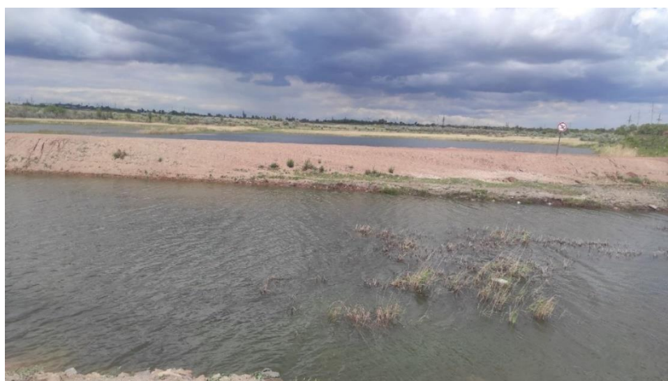
Рисунок 3.6 – Котлованы на месте провалов по улице Терешковой
