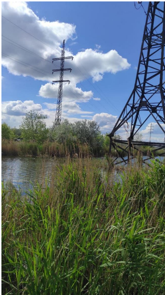
Рисунок 3.10 – Затопление опоры линии электропередач
